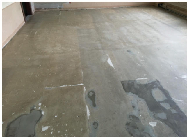
Starý podklad, který vyžaduje sanaci
